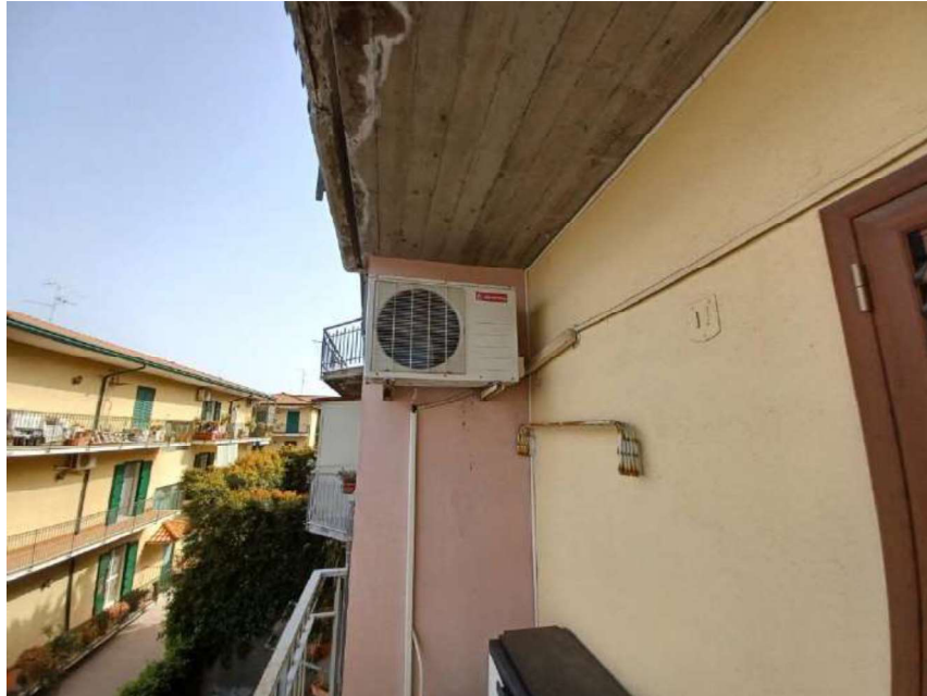
Foto 41 – Particolare impianto di climatizzazione
