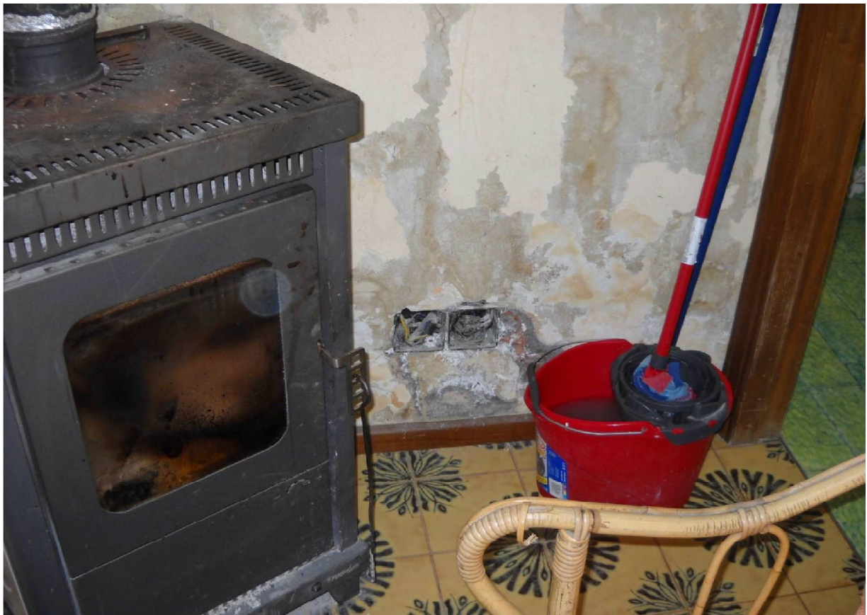
Foto 28. Vista delle prese elettriche e delle infiltrazioni di umidità
