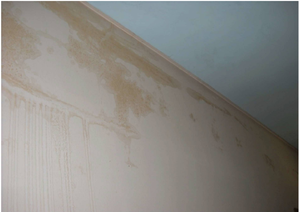
Foto 29. Dettagli delle macchie di umidità presenti sulle pareti
