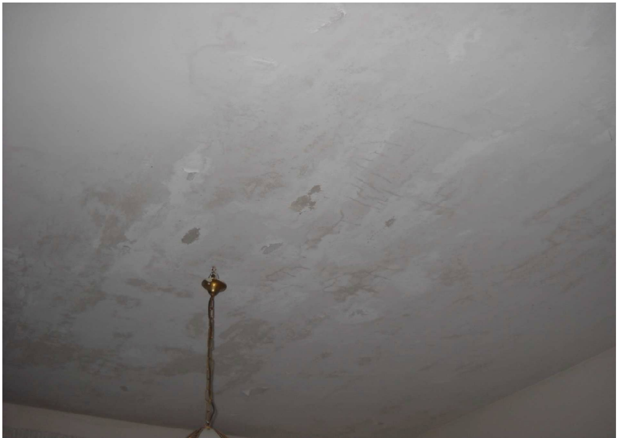
Foto 20. Vista delle tracce di umidità presenti sul soffitto della camera da letto
