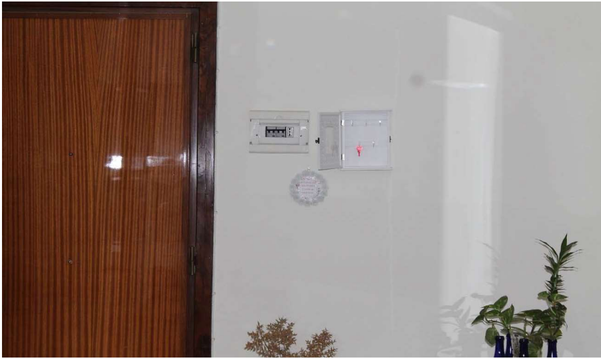
FOTO N. 6 – PORTA DI INGRESSO E INTERRUTTORE ELETTRICO GENERALE
