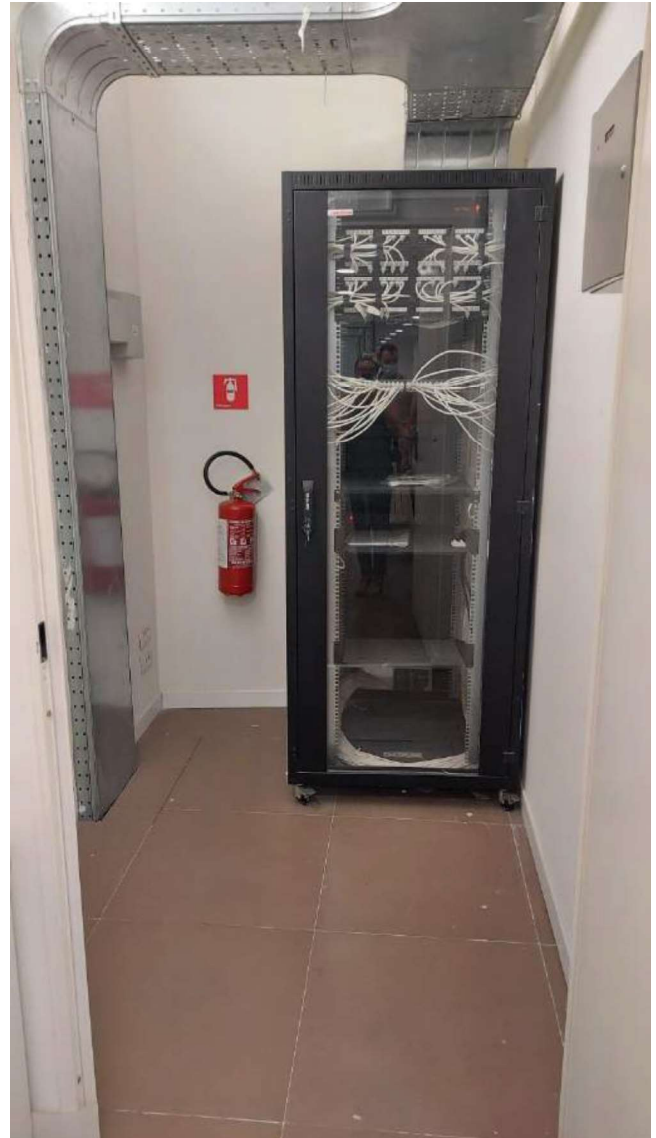
Foto 57. Locale tecnico al piano primo
