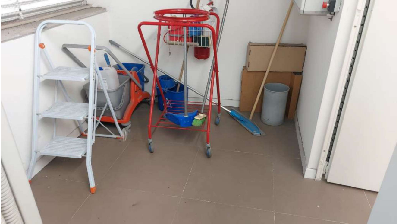
Foto 58. Locale condizionatori al piano primo
