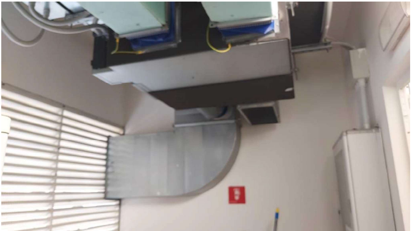
Foto 59. Locale condizionatori al piano primo
