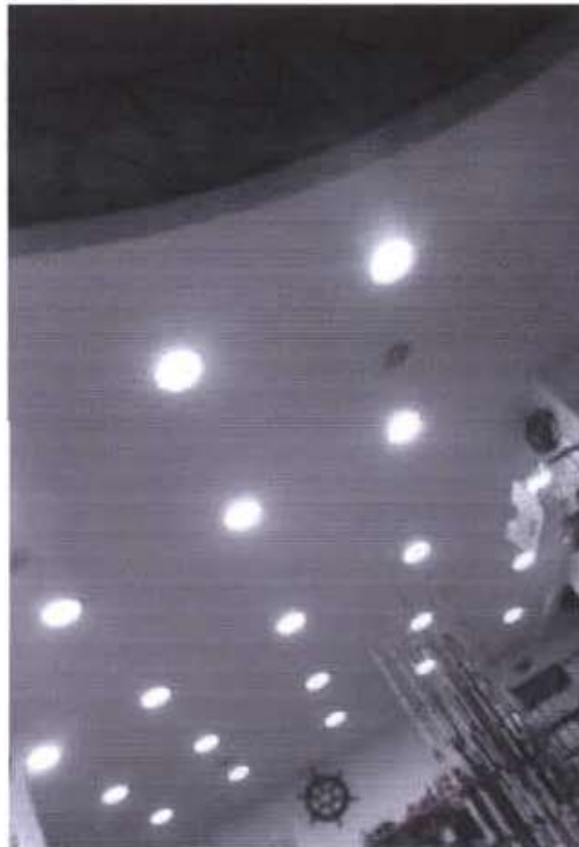
FOTO 10 SOFFITTO PIANO TERRA
