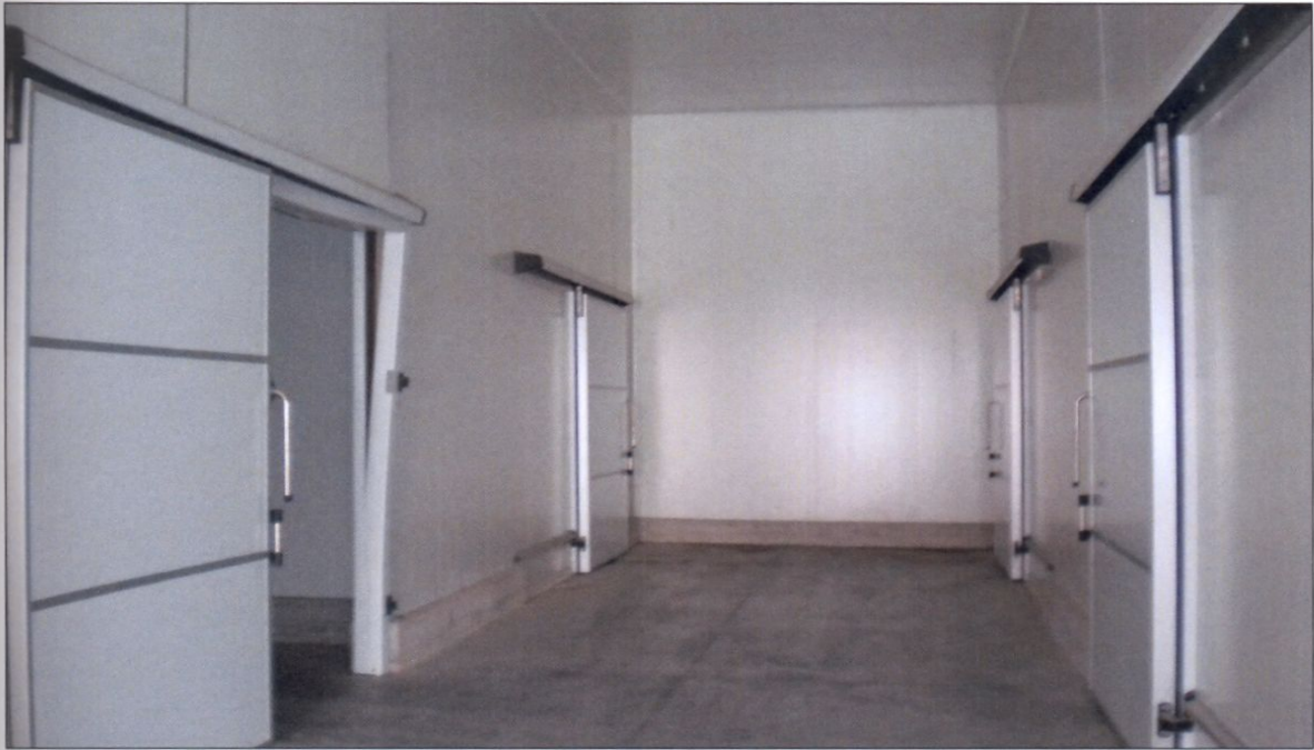
Cella frigorifera centrale _ Foto n. 28
