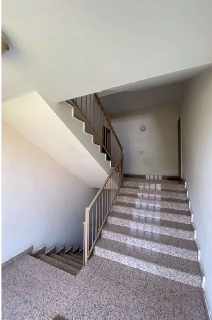
foto 8 - il piano terra dell'androne della palazzina B con la rampa di scale che serve i piani terra-rialzato, primo e secondo
