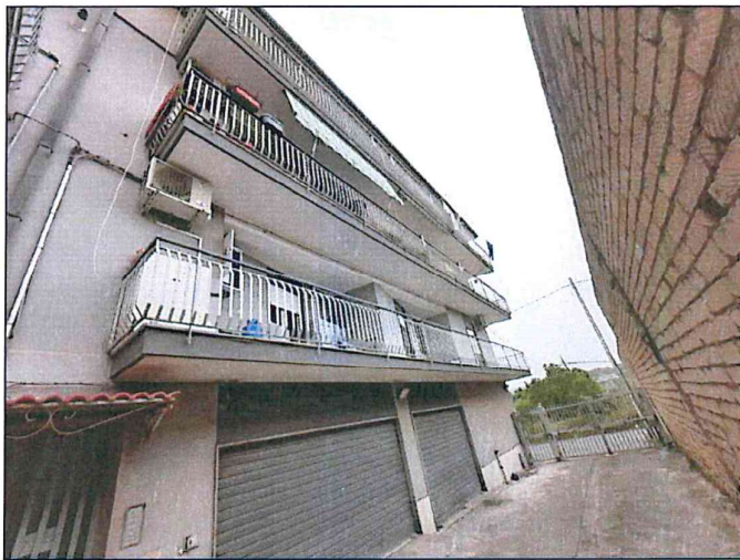
Foto 4-5 - Vista dei prospetti aventi affacci con balconi a giro su via Sant'antonio e su strada privata interna; da quest'ultima si accede ai garage ed al corpo scala A. Le facciate e i balconi si trovano in buono stato conservativo.
